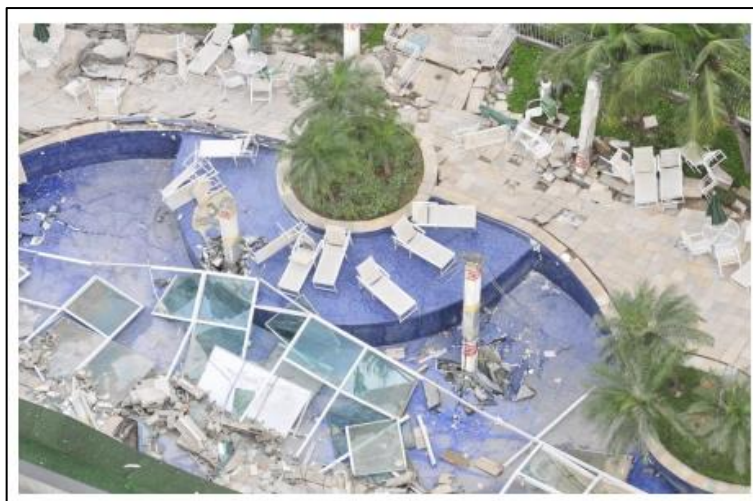
Figura 4.9 – Pilares quase intactos após colapso de laje em condomínio residencial.
