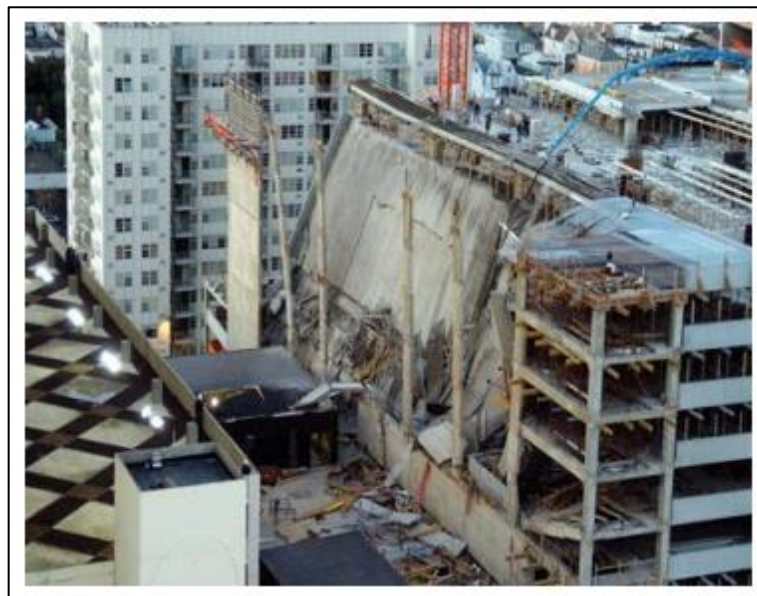
Figura 4.8 – Pilares quase intactos após colapso do Cassino Tropicana.
