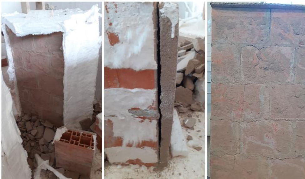
Figura 41: CONJUNTO DE ARGAMASSA COM INCORPORADOR DE AR: À esquerda a pequena parede ao ser resfriada. No meio o prisma sem a aderência do revestimento. À direita com poucas fissuras após os 120min
