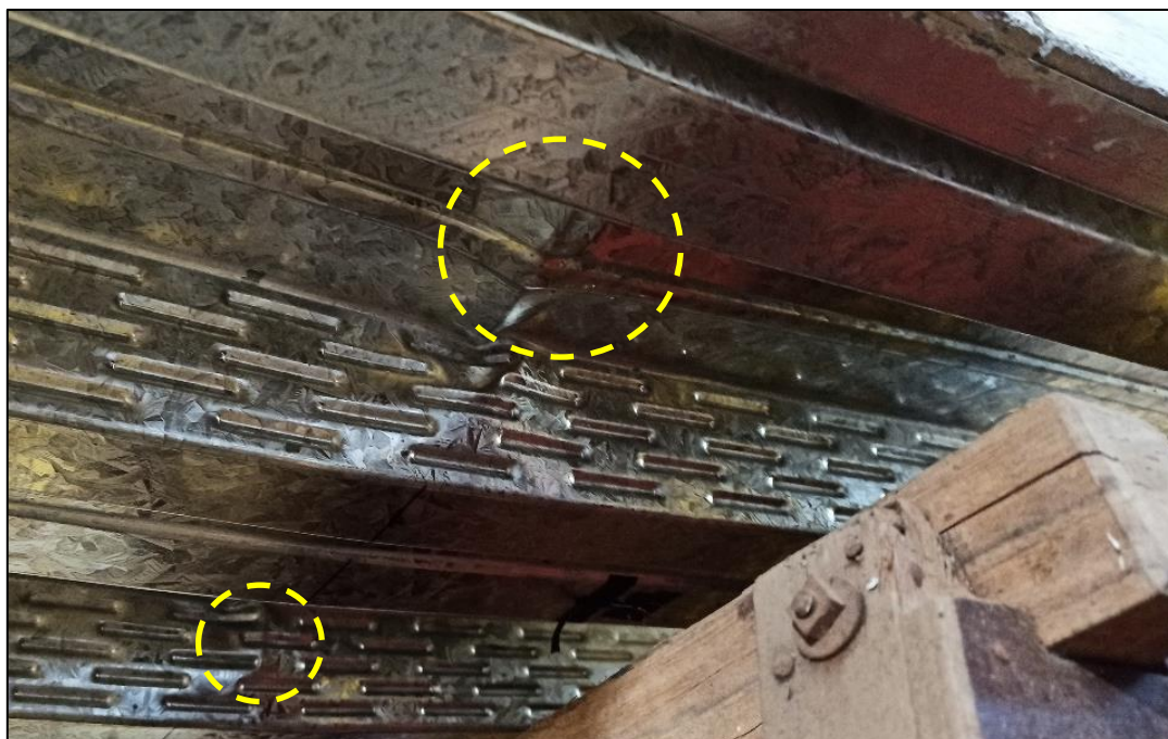
Figura 8.10 - Ondulações na parte comprimida da fôrma de aço no final do ensaio
