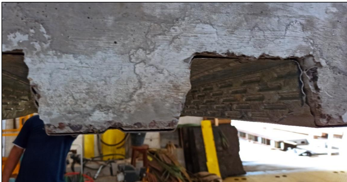
Figura 8.9 - Separação vertical entre aço e concreto no vão de cisalhamento observado nas extremidades
