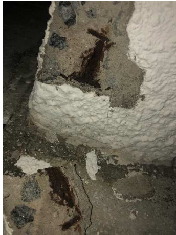
Figura 1 - Corrosão atuando em um pilar causando destacamento do cobrimento e exposição da armadura.
