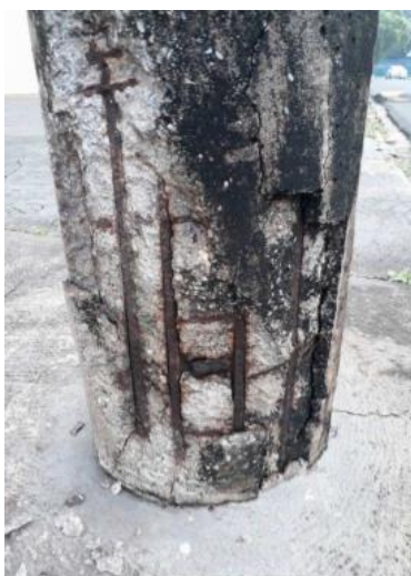
Figura 1-1- Corrosão em armadura de um pilar de concreto armado.
