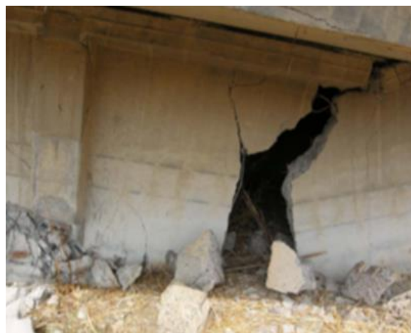
Figura 1-2- Viaduto Petrulla após o colapso.
