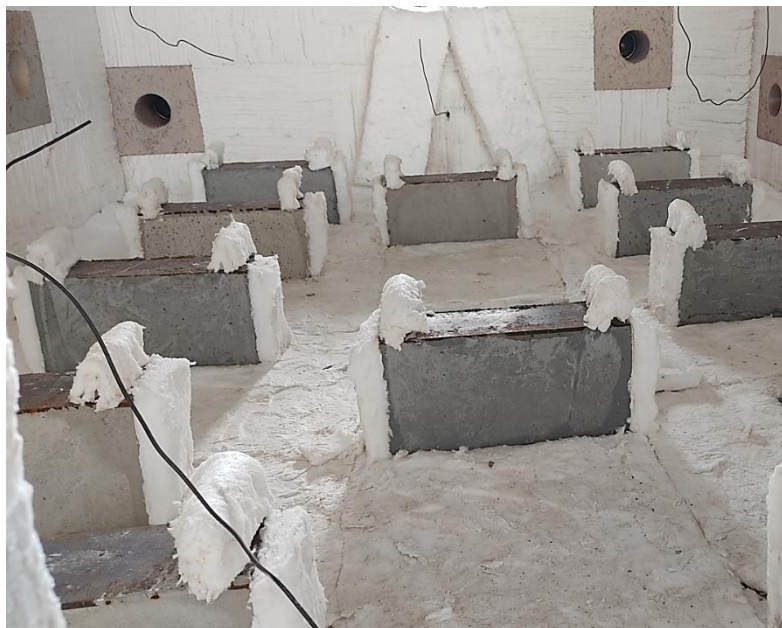
Figura 5.11 – Corpos de prova mistos devidamente protegidos para realização do ensaio em situação de incêndio
