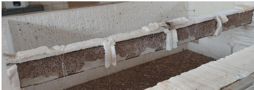
Figura 6.33 - Viga VB-0 pós-fogo: (a) Lado 1 e (b) Lado 2
