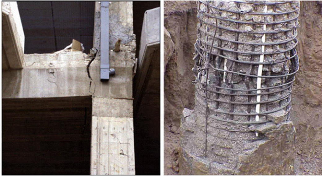
Figura 2 – Dano à flexão observado em ligação viga-pilar e base de pilar.
