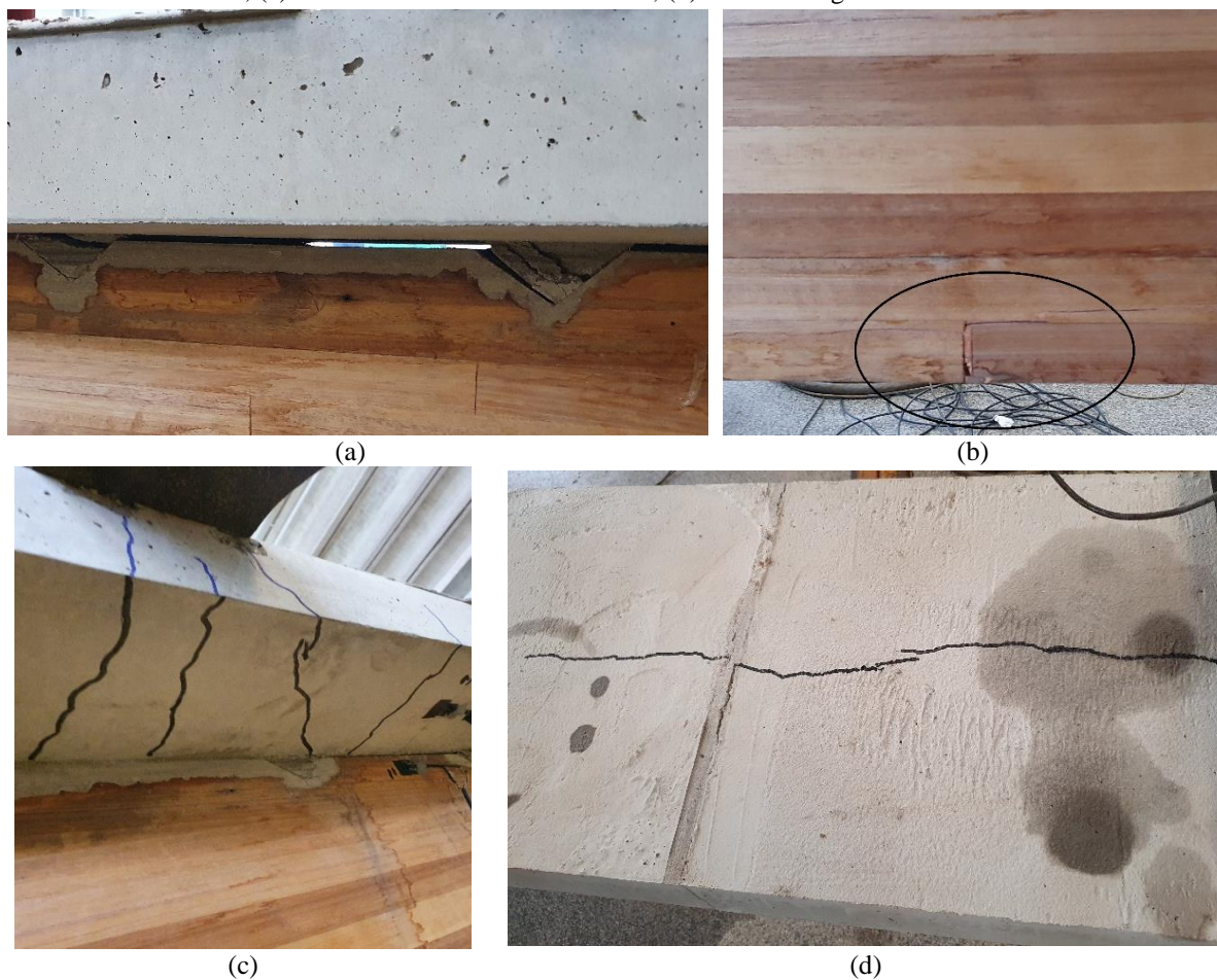
Figura 4.12 – Ruptura viga E4-A-L4: (a) ruptura da ligação e separação da laje; (b) ruptura por tração da madeira; (c) fissuras transversais no concreto; (d) fissuras longitudinais no concreto
