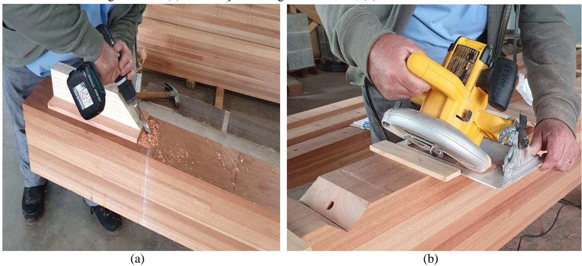
Figura A.7 – (a) Pré-furação das vigas de madeira; (b) Corte dos entalhes.
