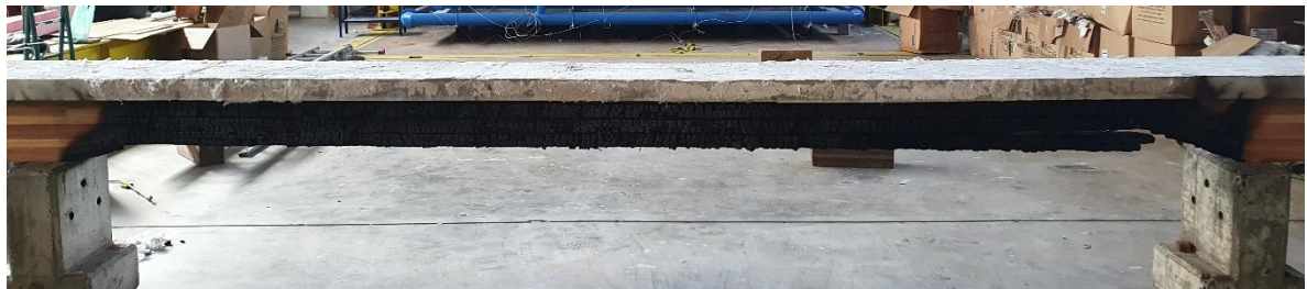
Figura 5.11 – Observações experimentais da viga E3-I-L2: (a) visão geral no pós ensaio; (b) perda de umidade; (c) fissuras no concreto.
