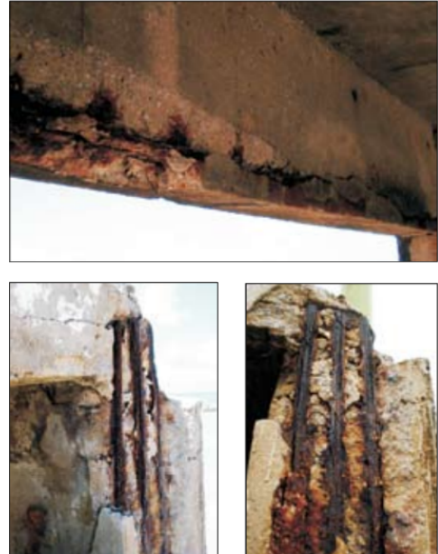
(b) Corrosão das vigas e armaduras
