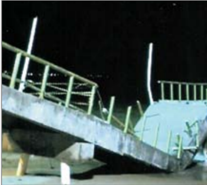
(a) Ruína no vão médio
