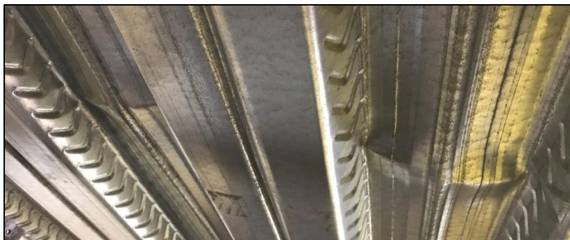
Figura 6.31 – Ondulações na parte comprimida da fôrma de aço no final do ensaio (Laje 1)
