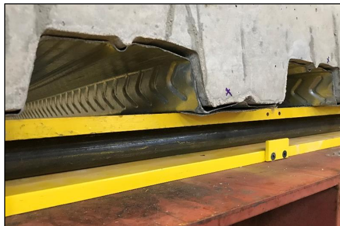
(b) Deslizamento de extremidade
