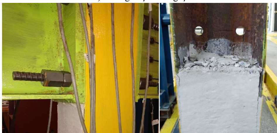
b) Deformada das mesas e descolamento do concreto do pilar misto
