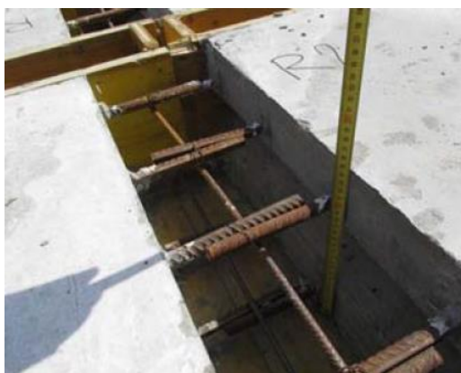
Figura 1.1 - Ligação entre elementos de concreto preenchido com UHPC (Fonte: VÍTEK et al., 2016)
