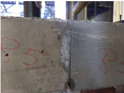
Detalhe da ruptura
