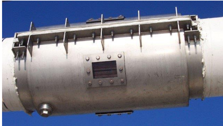
Figura 15 – Exaustor em cabo de ponte pênsil componente do sistema de desumidificação
