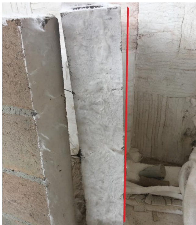
Figura 4.30 - Curvatura apresentada por uma das paredes do trio compartimentado
