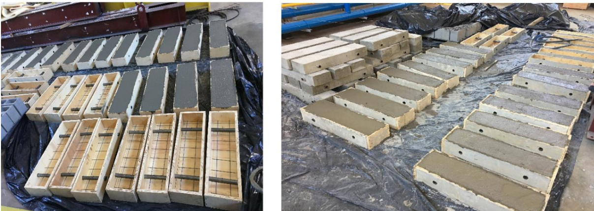
(b) montagem das formas com as telas soldadas e os tubos de aço, e concretagem das bases
