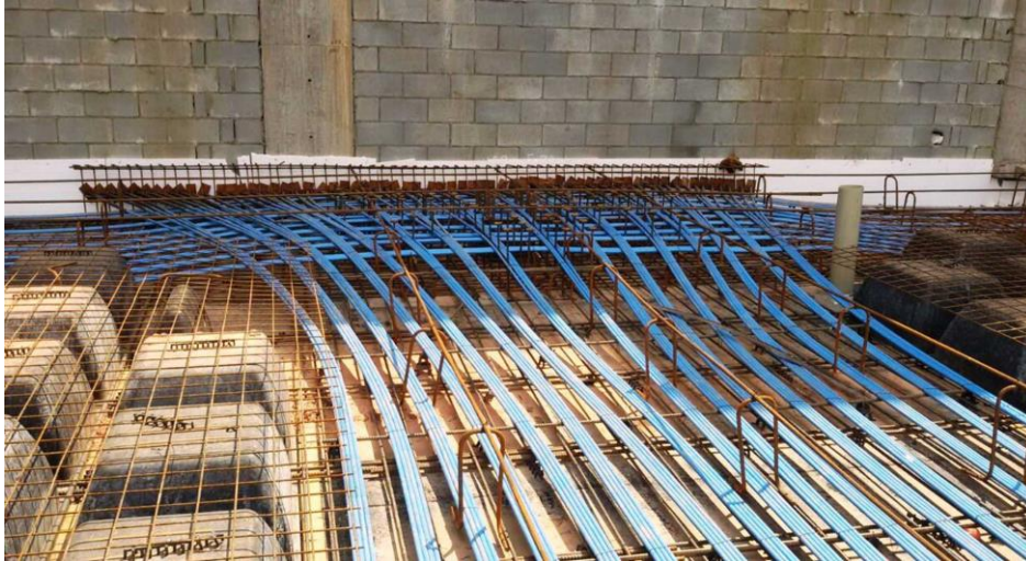
Figura 3 – Cordoalhas engraxadas em lajes de um edifício residencial. Fonte: MAC Protensão (2019).
