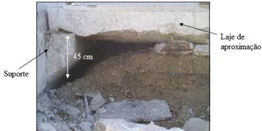
Figura 4 – Perda de solo de aterro observado na rodovia US 65, Iowa, EUA
