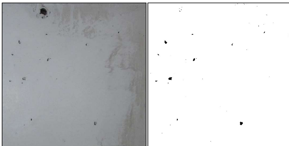
Figura 4.36 – Parede C40 9%, Quadrante 2, Face Frontal – Falha: 0,171%; Nota: 1,80.
