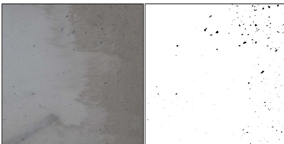
Figura 4.28 – Parede C40 referência, Quadrante 2, Face Frontal – Falha: 0,578%; Nota: 3,07.
