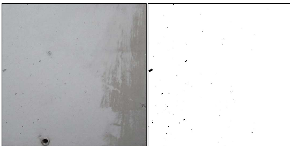
Figura 4.38 – Parede C40 9%, Quadrante 4, Face Frontal – Falha: 0,104%; Nota: 1,33.
