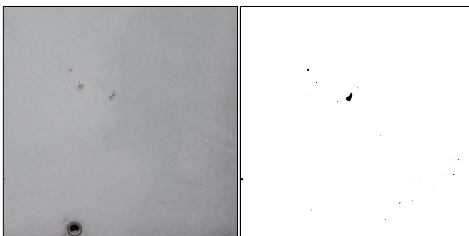
Figura 4.46 – Parede C40 15%, Quadrante 4, Face Frontal – Falha: 0,083%; Nota: 1,18.
