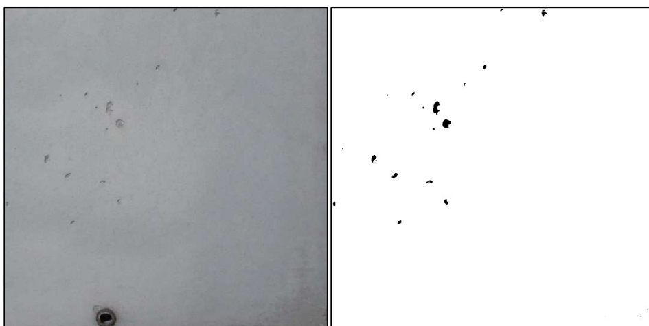
Figura 4.49 – Parede C40 15%, Quadrante 3, Face de Trás – Falha: 0,254%; Nota: 2,22.
