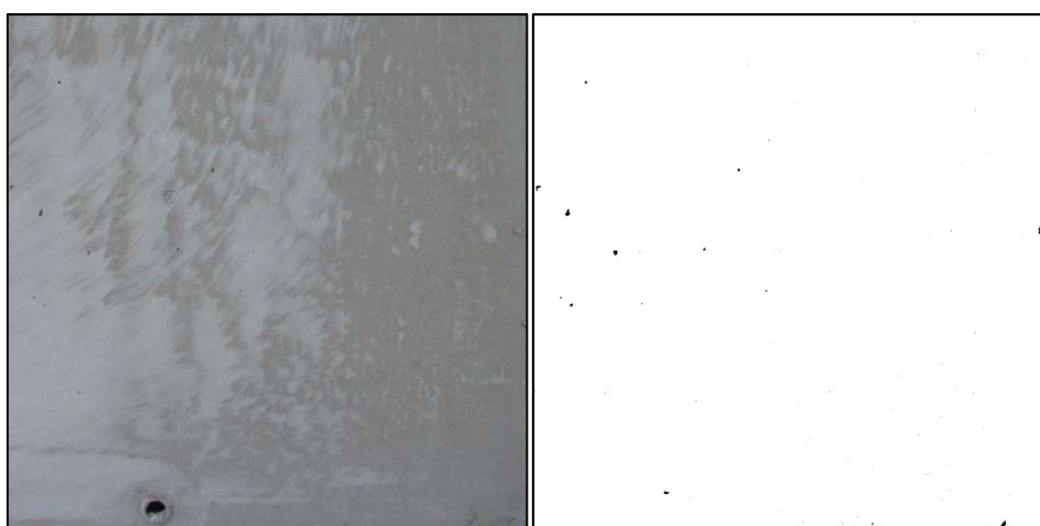
Figura 4.41 – Parede C40 9%, Quadrante 3, Face de Trás – Falha: 0,106%; Nota: 1,34.
