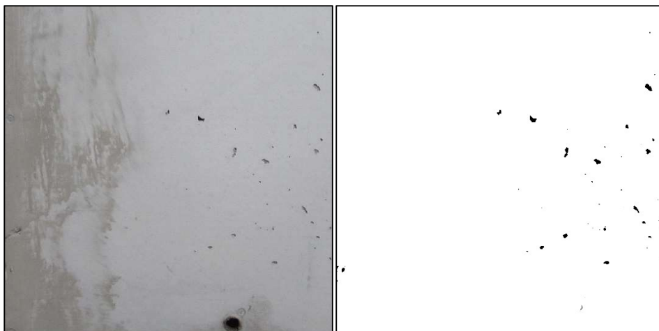
Figura 4.37 – Parede C40 9%, Quadrante 3, Face Frontal – Falha: 0,229%; Nota: 2,12.
