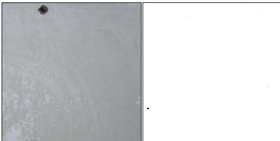
Figura 4.39 – Parede C40 9%, Quadrante 1, Face de Trás – Falha: 0,016%; Nota: 1,00.
