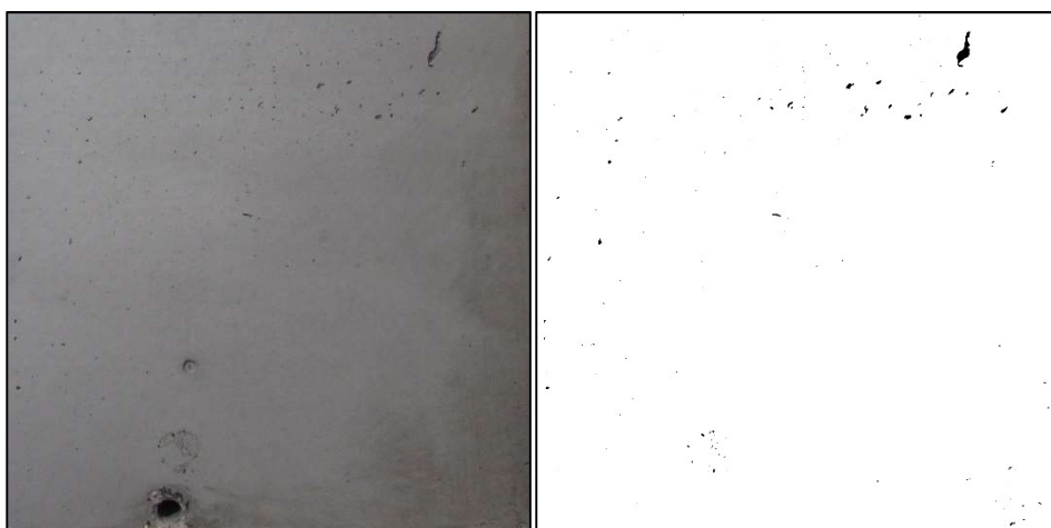
Figura 4.33 – Parede C40 referência, Quadrante 3, Face de Trás – Falha: 0,194%; Nota: 1,96.
