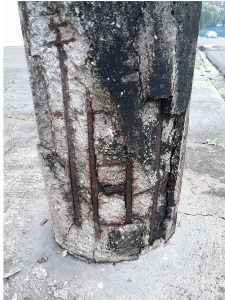
Figura 1.1 – Corrosão avançada das armaduras de um elemento de concreto armado Fonte: arquivo pessoal
