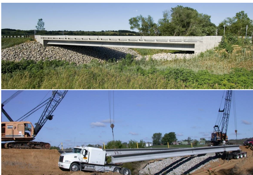
Figura 2.12 – Mars Hill Bridge (EUA): ponte rodoviária composta de vigas pré-moldadas de UHPFRC com 33,5 m de comprimento sem armadura transversal (Fonte: www.ductal.com )
