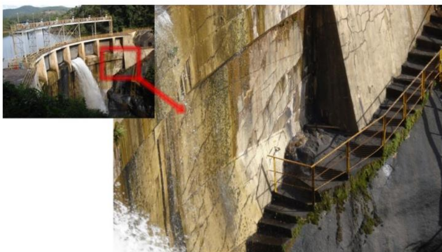
Figura 1.2 - Fissuração na barragem de Minas Gerais.
