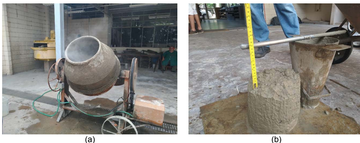
Figura 3. 1 – Concretagem das amostras: (a) betoneira utilizada e (b) realização do ensaio de abatimento
