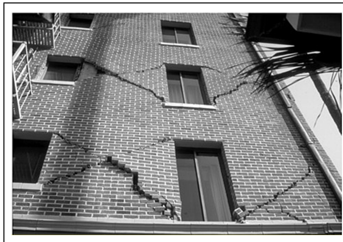
Figura 1.2 – Danos em edifício de alvenaria estrutural em Northridge CA, USA, 1994.
