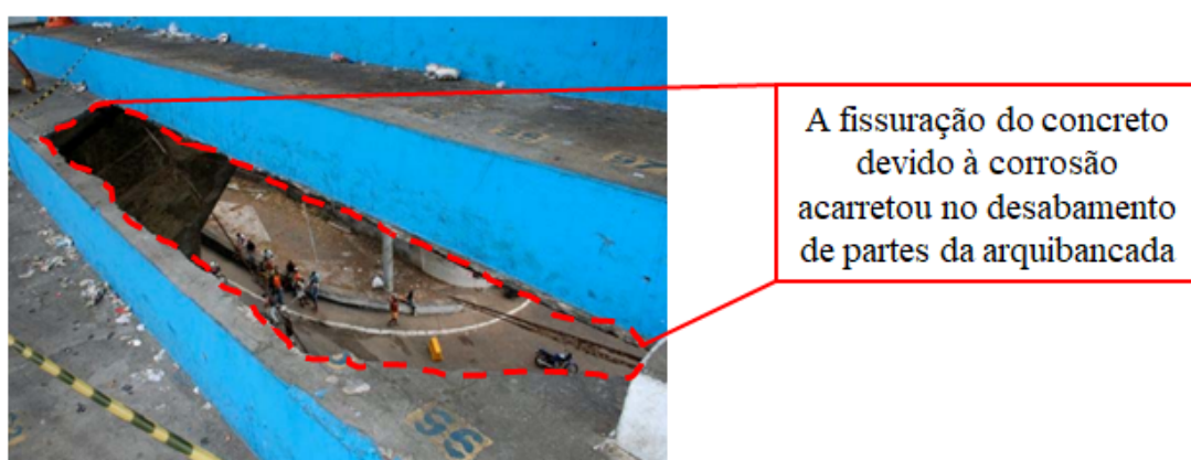
Figura 1.3 – Desabamento de arquibancada no Estádio Octávio Mangabeira em 2007.
