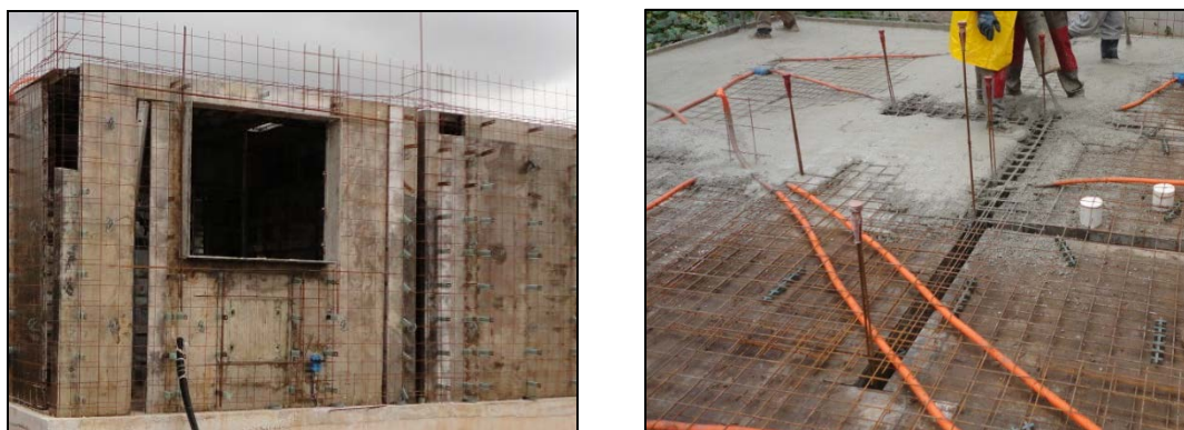
Figura 2.3 – Armação das paredes e lajes de um edifício de parede – Fonte: Autor (2012)
