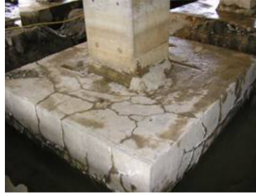
Figura 1 – Vista Superior de Pilar e do Bloco de Fundação atacados pela RAA.
