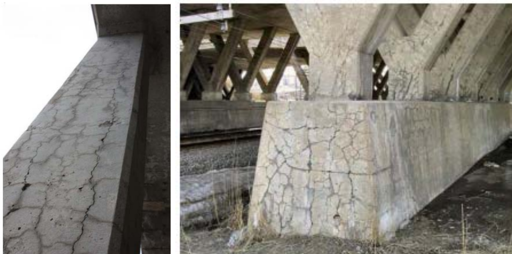
Figura 1.1 - Estruturas afetadas pela reação álcali-agregado.
