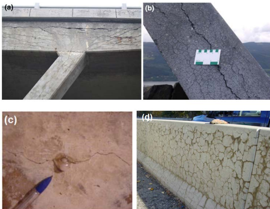
Figura 2.16: Manifestações patológicas resultantes da RAA. (a, b) Fissuração orientada e paralela à direção da armadura em elementos de concreto armado. (c) Exsudação de gel através de uma fissura. (d) Fissuração mapeada característica da RAA.
