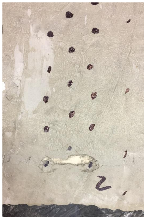
Figura 5.23 - Região do tubo flambado
