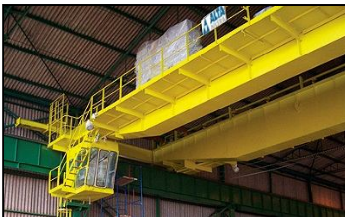
Figura 2.6: Ponte rolante operada por cabine.
