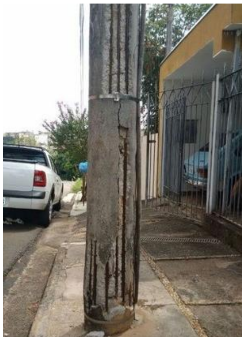
Figura 1.3 – Poste deteriorado devido processo de corrosão na cidade de São Carlos/SP.
