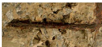
Figura 1.1 - Corrosão devido à carbonatação.
