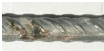
Figura 1.2 - Corrosão devido à ação de cloretos.
