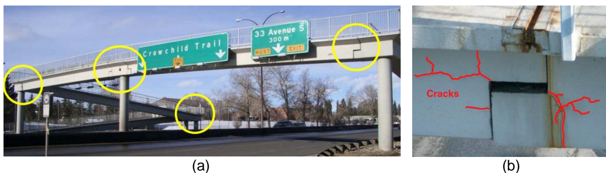
Figura 1.3 – Passarela de pedestre construída com vigas pré-moldadas com apoios em dente: a) detalhe das ligações com dentes de concreto; b) detalhe das fissuras no canto reentrante.
