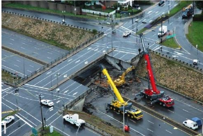
Figura 1.5 – Colapso do viaduto da Avenida Concorde.
