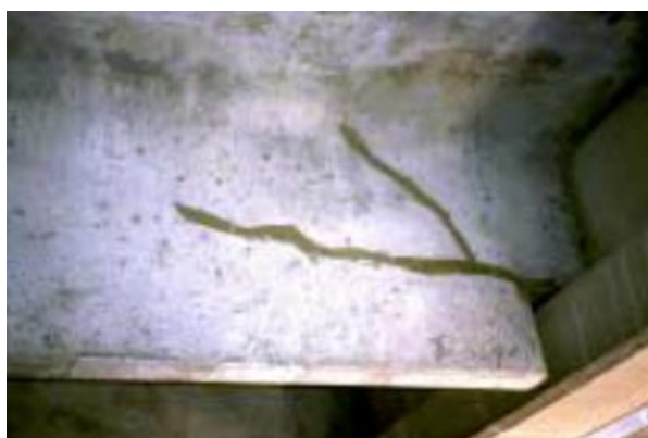
Figura 1.4 – Fissuras no canto reentrante do dente de concreto.
