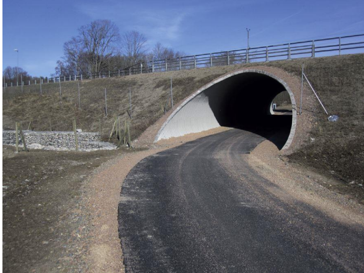
Figura 2.4 – Típica galeria flexível corrugada sob a estrada E6 em Saltkällan, Suécia
