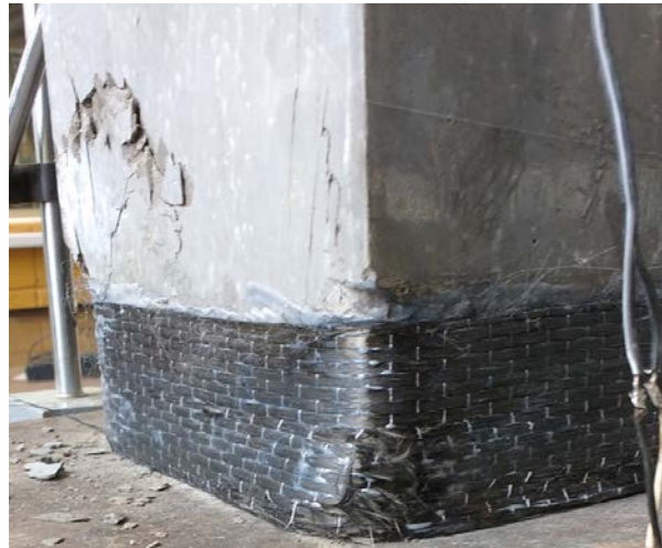
Figura 4.41 – Ruína do pilar S15F
