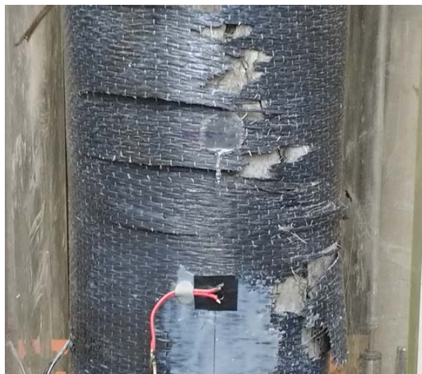
Figura 4.29 – Ruína do pilar C25FC
