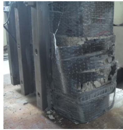
(d) Ruptura do PRP no menor lado do pilar
