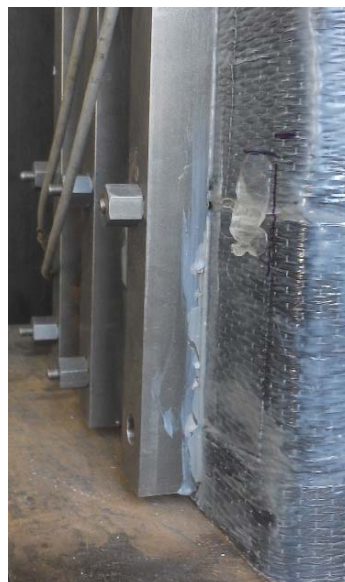
(b) Ruptura do tirante junto à extremidade inferior do pilar
