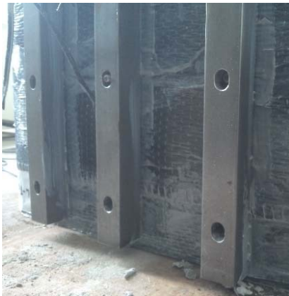
(c) Ruptura dos tirantes da extremidade do pilar
