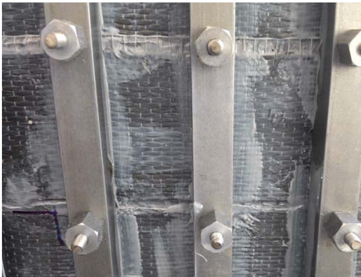
(d) Fissura horizontal indicando esmagamento do concreto na região sem PRF
