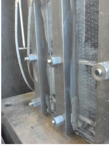
(a) Fissura horizontal indicando esmagamento na região sem PRF
