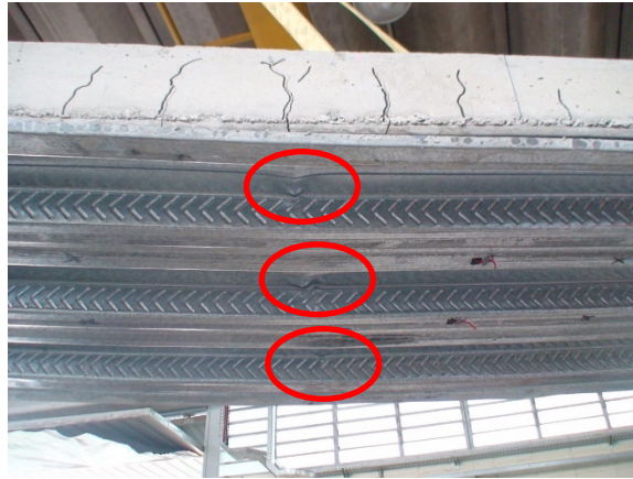
Figura 2.6 – Ondulações nas ondas altas da fôrma de aço no “estágio final de comportamento” (SIEG, 2015).
