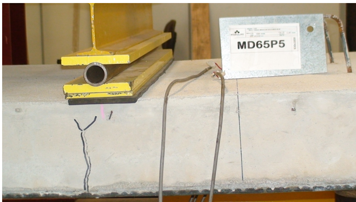
Figura A.11 – Aspecto típico da fissura na região da força aplicada, após o deslizamento.
