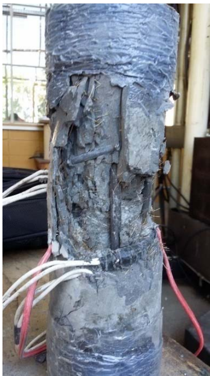
Figura 9.13 – Flambagem das armaduras longitudinais Pilar MOD75ICF
