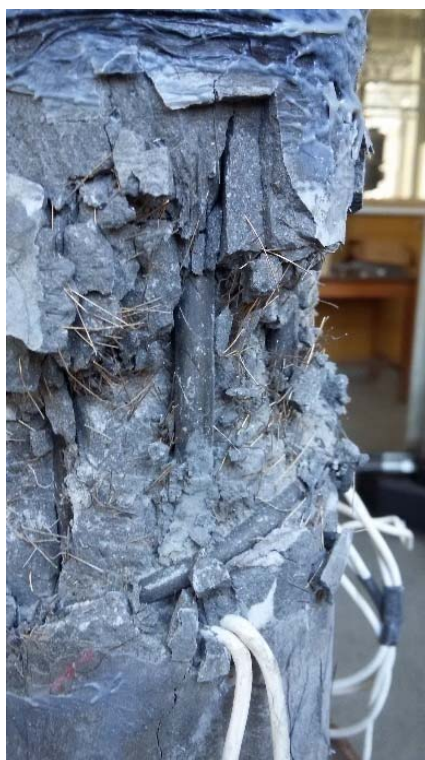
Figura 9.14 – Pilar MOD75TCF após a ruptura
