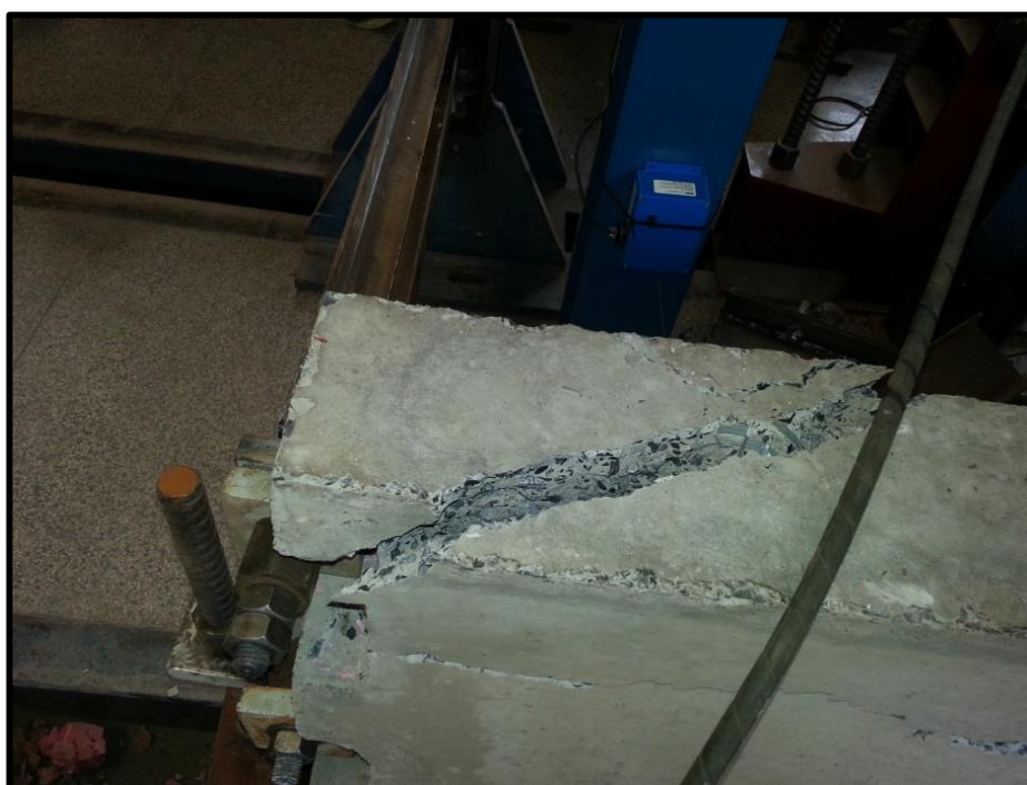
Figura 4.28 – Rompimento da parte superior próxima ao conector da barreira BNJ-M
