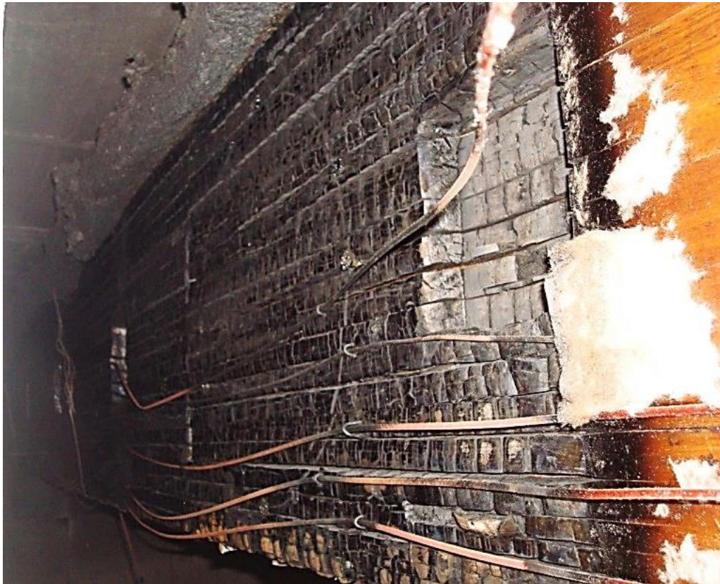
Figura A.7: Viga no interior do forno depois de encerrado o ensaio e resfriamento do forno.
