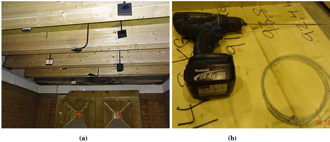
Figura 2.12: Termopares: (a) interior do forno; (b) equipamentos para instalação no interior da seção.
