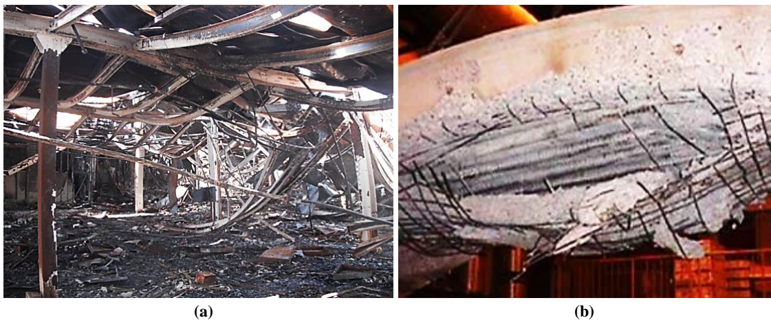
Figura 2.5: Estruturas afetadas por altas temperaturas: (a) perfis de aço; (b) elemento de concreto armado.
