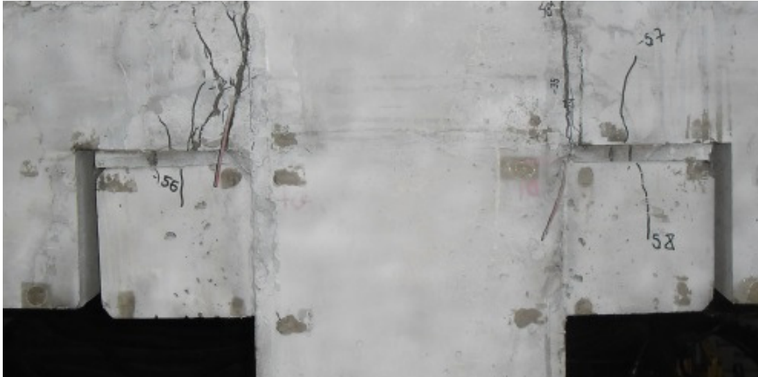
Figura 5.19 – Detalhe das fissuras da ligação no consolo
