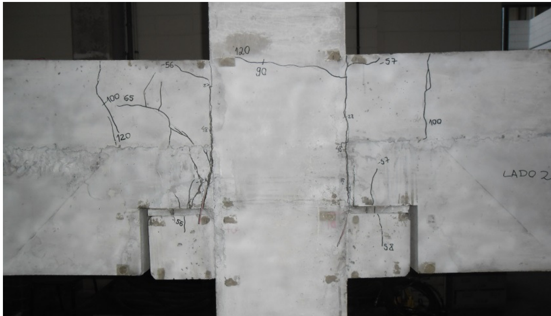
Figura 5.10 – Detalhe das fissuras da ligação
