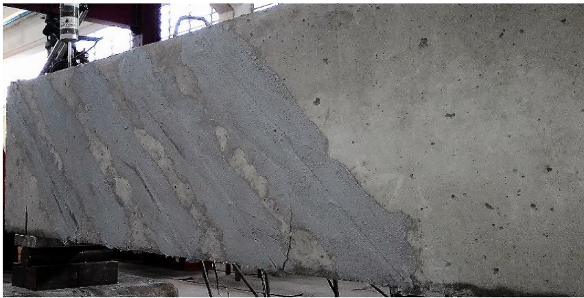
Figura 6.4 – Fissuração da viga V50 CFRP
