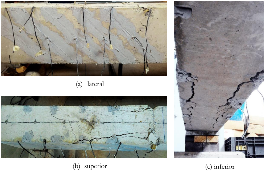
Figura 6.5 – Ruptura da viga V50 CFRP
