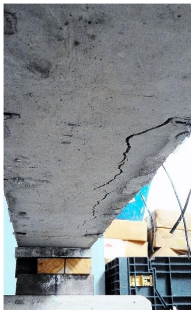
Figura 6.6 – Ruptura da viga V50 40%
