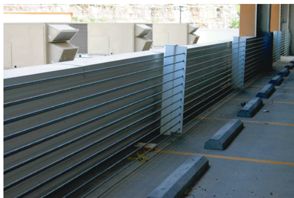
Figura 4.8 – Cordoalhas protendidas conhecidos nos EUA como “Barrier Cables”. 6
