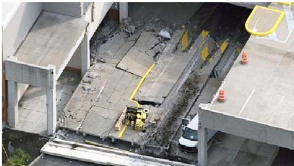
(a) vista superior da parte do estacionamento destruída; o colapso da viga de fachada de seção “L” e dos elementos de piso não afetaram as demais partes do estacionamento e do edifício da loja ao lado;
