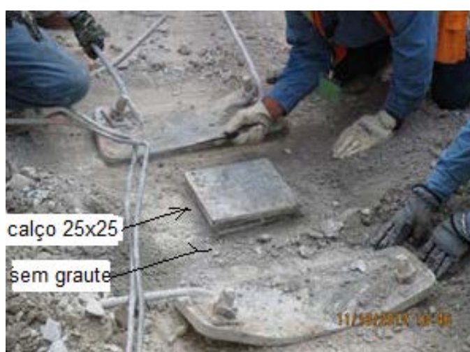
(b) inspeção na base do pilar 3 comprovou que não houve grauteamento entre o calço (25 x25 cm 2 ) e a sapata.
