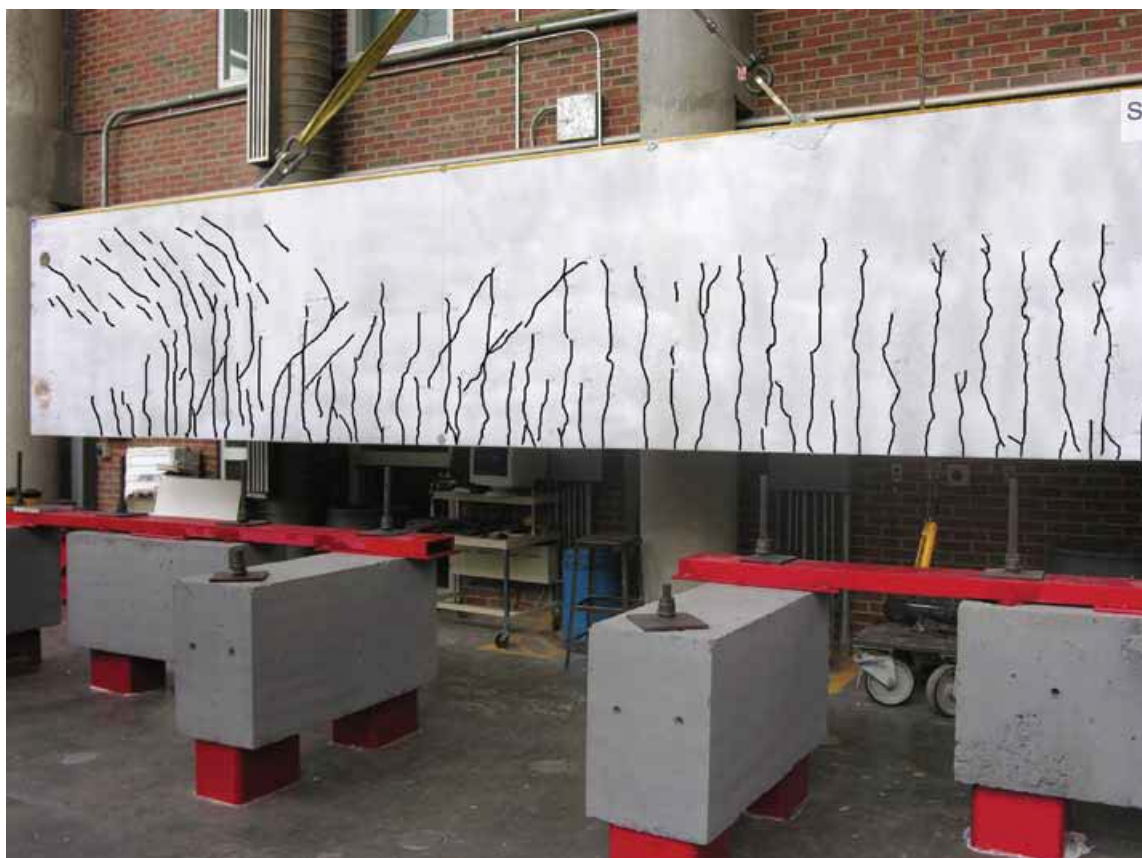
Figura 2.23 – Fissuração observada na face externa de viga de seção “L” pré-moldada de concreto [LUCIER et al. , 2011a].
