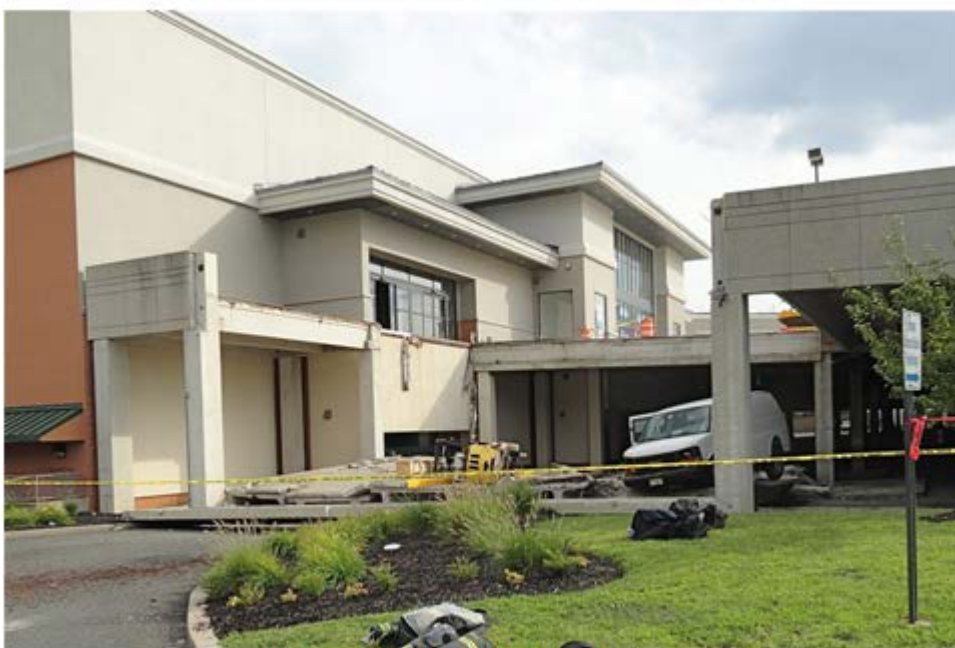
(b) vista frontal do local do colapso.
