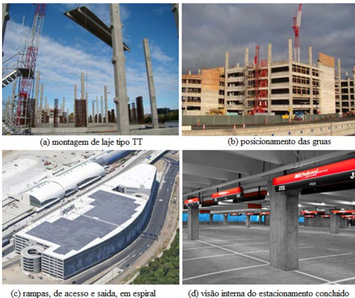
Figura 1.3 – Fases distintas do estacionamento de múltiplos andares acoplado ao terminal do aeroporto de San Jose, CA, EU. [SHUTT, 2011].
