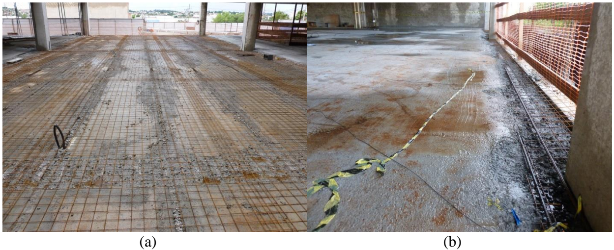
Figura 36 - Armadura em malha da capa estrutural (a) antes da concretagem da capa (b) detalhe da malha sobre a viga
