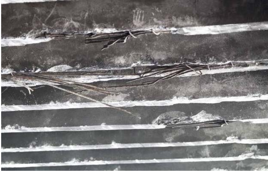
Figura 4.3 - Detalhe: Corrosão de vigas no Elevado do Joá
