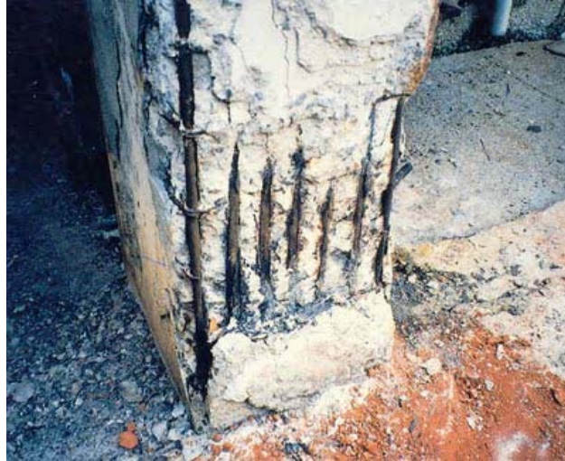
Figura 1.1 - Corrosão avançada das armaduras de um pilar Fonte: http://speranzaengenharia.ning.com/page/corrosao
