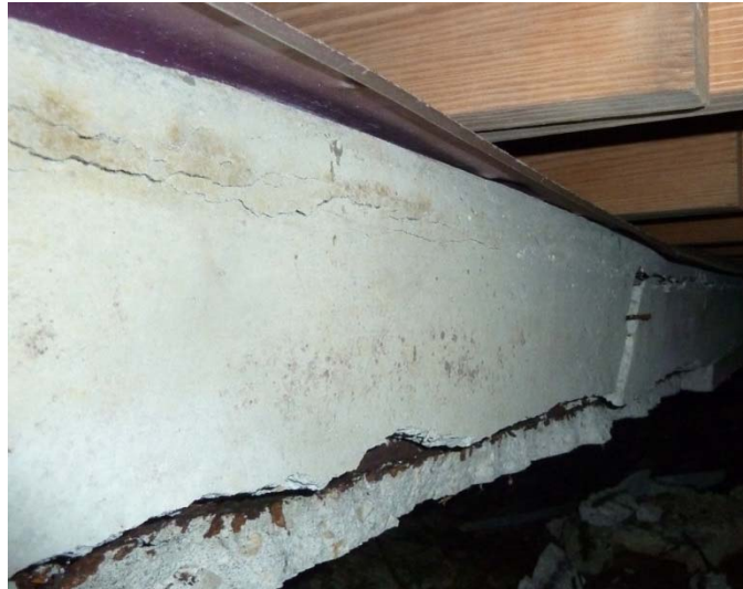
Figura 1.2 - Corrosão avançada das armaduras de uma viga Fonte: http:// structuralhelp.com/cracks-and-spalling-in-concrete
