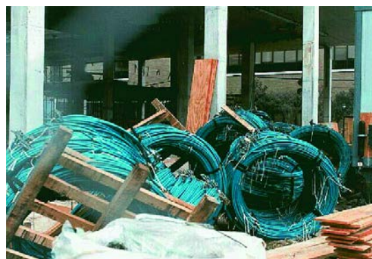
Figura 115 - Estoque incorreto de cabos. Fonte: VASCONCELOS (2013).
