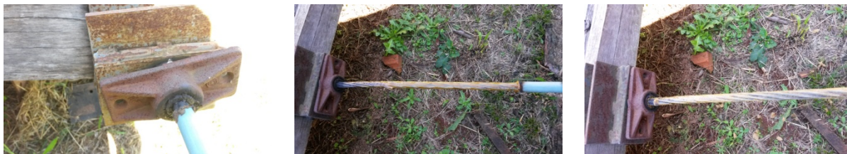
Figura 113 - Placa de distribuição e ancoragem corroídas, cordoalha protegida pela bainha e em perfeito estado. Fonte: O AUTOR (2014).
