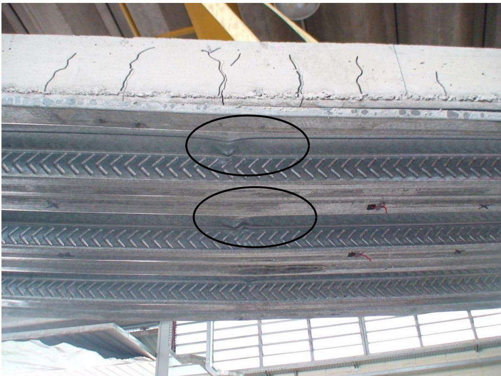
Figura 6.3 – Ondulações nas mesas superiores da fôrma metálica.
