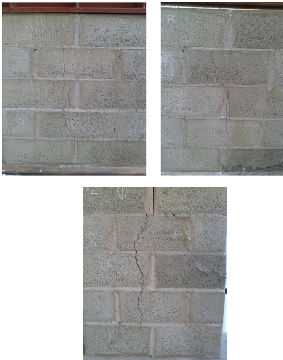
Figura 6.16 – Propagação de fissuras verticais de tração (Fonte: autor)
