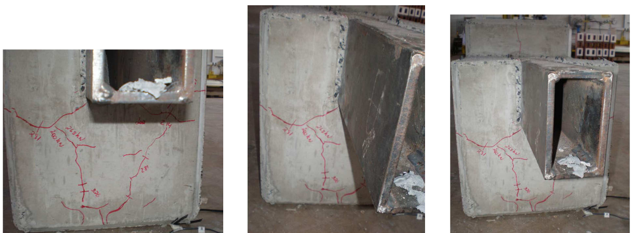
b) Fissuras na face inferior do dente metálico
