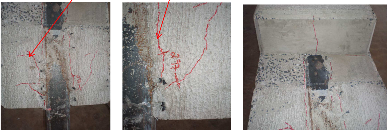
b) Fissuras na face superior da viga junto ao dente metálico
