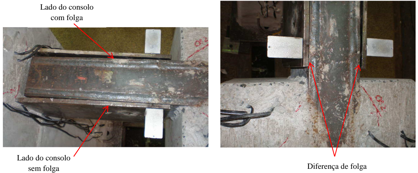
Figura 4.48 – Diferença de folga entre os elementos da ligação após a execução do ensaio.
