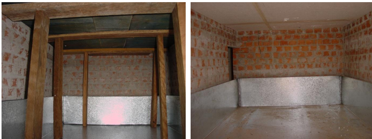
Figura 6. 28 – Detalhes dos escoramentos para a confecção da laje do modelo físico reduzido.
