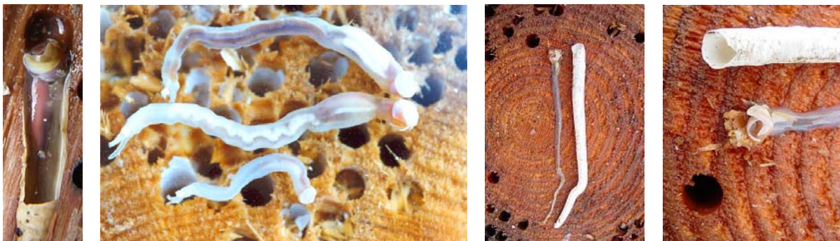
Figura 3.49. Características visuais de diagnóstico de teredos: orifícios, túneis, carcaças. Os túneis estendem-se por toda a seção transversal e são geralmente cobertos com carcaças brancas de cálcio.
