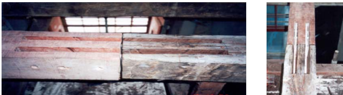
Figura 5.30. Reforço com placas de fibra de vidro coladas com resina de poliéster. Fonte: CRUZ (2004).
