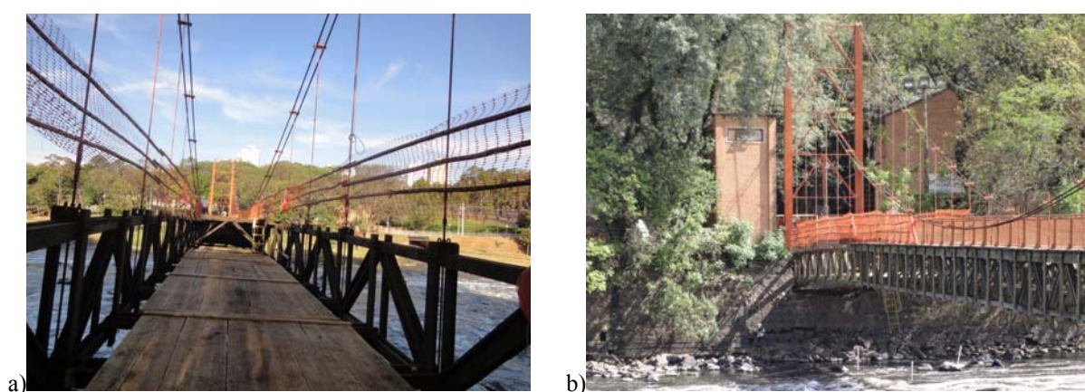
Figura 5.52. Com a remoção de aproximadamente um quarto do total das tabuas que compõem o tabuleiro da passarela e de 26 das transversinas do banzo superior nessa região, foi perceptível observar em Inspeção Visual Geral a inversão na deformação global da estrutura treliçada de madeira, por alívio do peso próprio com a retirada dessas peças. Foto: BRITO (Inspeção in loco em 09/08/2013)
