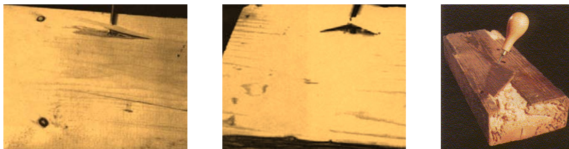
a) madeira sã: lascas longas b) biodeterioração: rompimento abrupto c) Detecção de brocas
