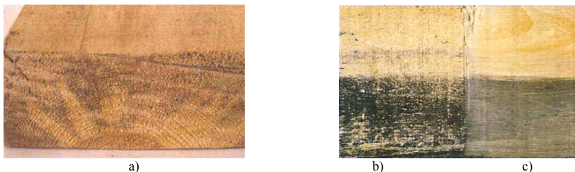
Figura 3.8. a) Características visuais de seção transversal de madeira atacada por fungos manchadores cromogêneos, ARRIAGA et al (2002); b) aspecto macroscópico de madeira atacada por fungos manchadores na superfície, Foto: Sérgio Brazolin, em LELIS et al (2001) IPT; c) superfície aplainada (observar as manchas azuladas causadas pelos fungos, Foto: Sérgio Brazolin, em LELIS et al (2001) IPT.
