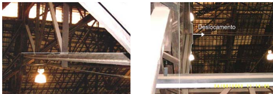
Figura 3.58. Deformações excessivas em treliças causadas por deslizamento de ligações entre a força e o momento aplicado: deslocamentos de apoios, flechas excessivas no meio dos vãos das treliças, efeitos da instabilidade lateral dos arcos. Fonte: ALVIM et al (2011)
