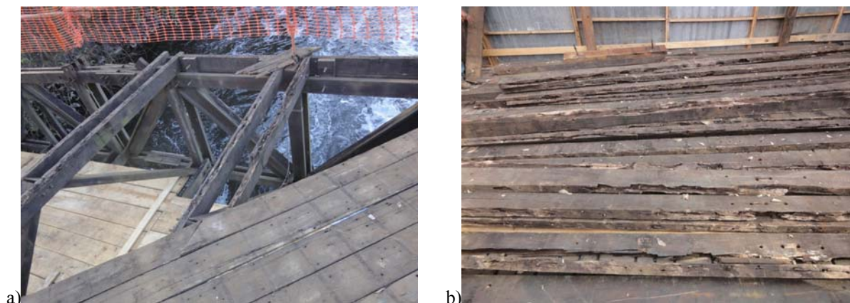
Figura 5.51. Biodeteriorações com características visuais de fungos apodrecedores, nas vigas transversinas superiores (TS) do módulo m13, em regiões de fixação das tábuas do tabuleiro: a) inspeções visuais detalhadas in loco ; b) 26 vigas transversinas superiores (TS) removidas da passarela, sem consentimento do LaMEM, armazenadas no pátio do Engenho Central. Foto: BRITO (Inspeção in loco em 09/08/2013)
