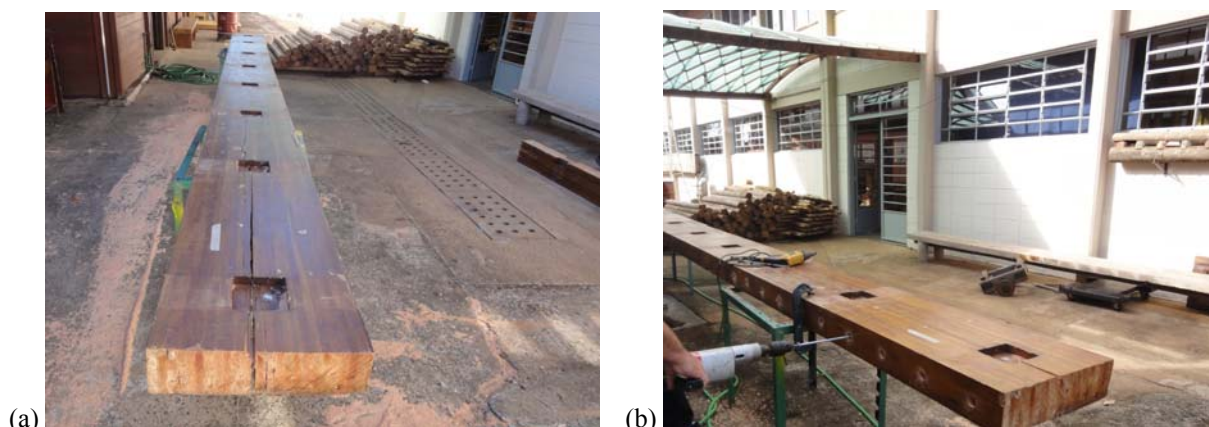
Figura 5.43. Proposta R1-MLC2: (a) Fenda longitudinal expressiva na Viga MLC; (b) Proposta de Técnica de reabilitação de delaminação e fenda longitudinal com parafusos auto-atarraxantes. Foto: BRITO Fonte: BRITO e CALIL JR. (2014)
