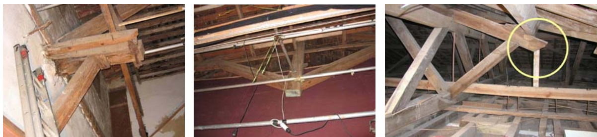
a) remoção parcial do banzo inferior
