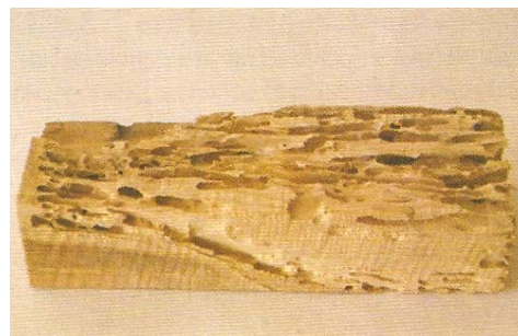
b) galerias em madeira degradada p/ H. bajulus
