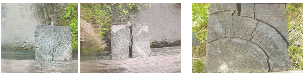
a) fendilhamento em topo de pilarete, na linha de parafusos
