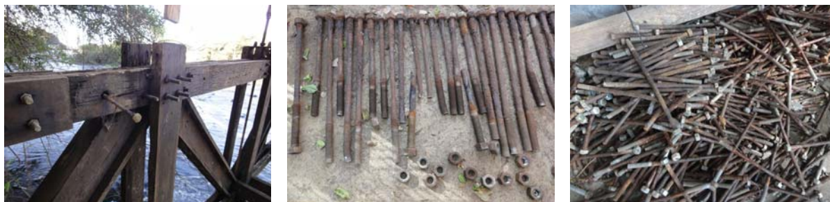
Figura 3.63. Corrosão de parafusos metálicos na região interna à madeira, nas ligações dos elementos estruturais de madeira de Eucalyptus citriodora tratada com CCA, do módulo m13 das treliças da Passarela Pênsil de Piracicaba , detectados na inspeção detalhada realizada em 9 de agosto de 2013. Fotos: BRITO (2013).
