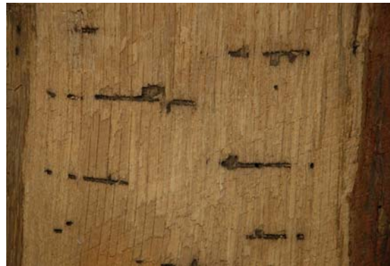
b) Sinais de deteriorações na madeira seca
