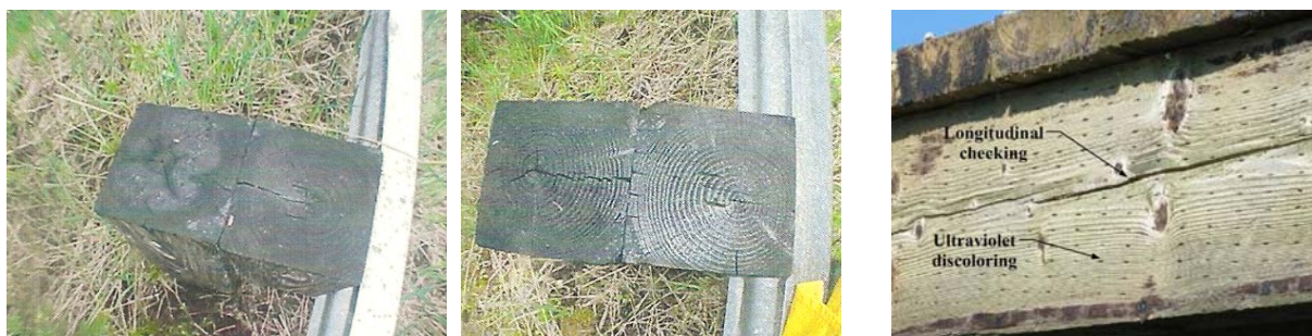
a) fendilhados e fendas de borda em extremidade, em topo de pilaretes
