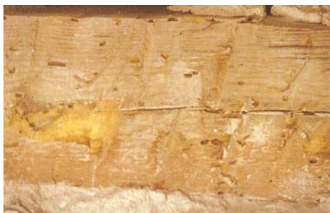
a) aspecto externo dos orifícios de saída
