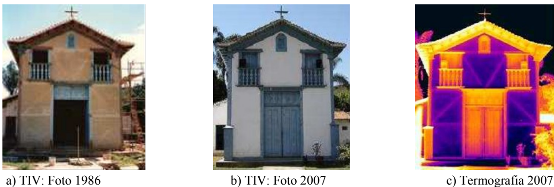
Figura 4.4. Processo de comparação visual qualitativo para validação dos resultados de CORTIZO (2007) no uso do método de termografia confrontando fotos, a fim de identificar similaridades entre os mesmos, para avaliação da estrutura das edificações históricas da capela.
