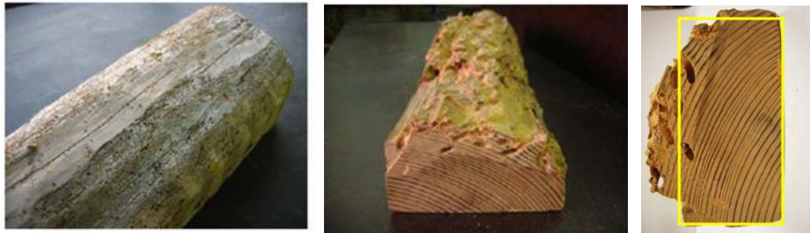
a) deterioração por carunchos pequenos b) deterioração por carunchos grandes c) Seção residual
