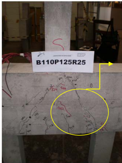
Panorama de Fissuração
