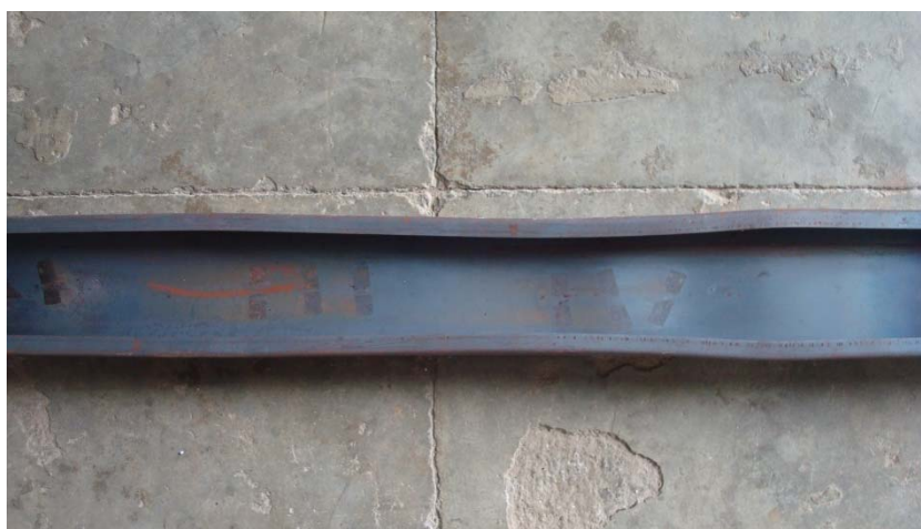
Figura 4.38: Detalhe da falha local na alma e distorcional no conjunto mesa enrijecedor.
